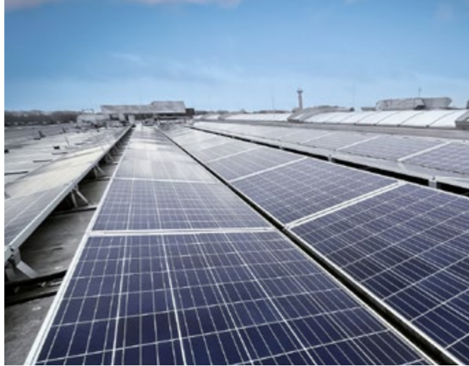
Photovoltaic system on the company building in Flintbek Photovoltaik Anlage auf dem Firmengebäude in Flintbek
