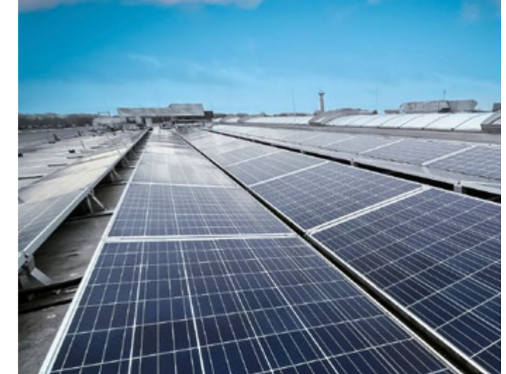
Photovoltaic system on the company building in Flintbek Photovoltaik Anlage auf dem Firmengebäude in Flintbek
